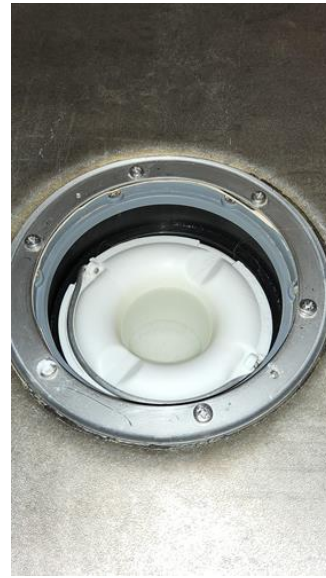
Avløpsrør (ink. sluk) - [Sluk bad]
