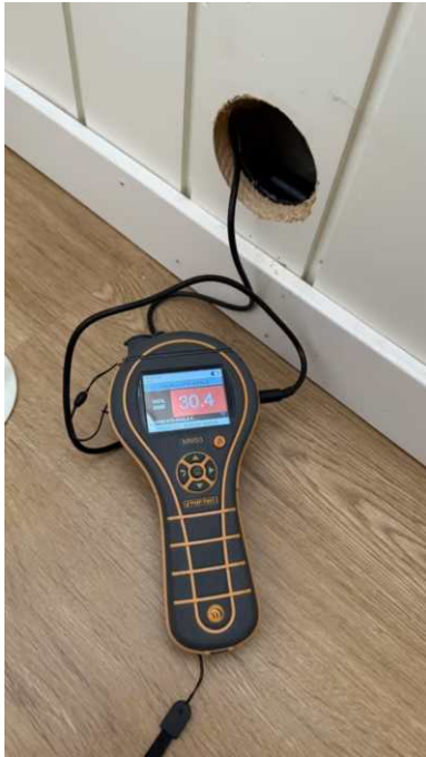
Fuktmåling over faregrensen for utvikling av sopp/ råteskader.
