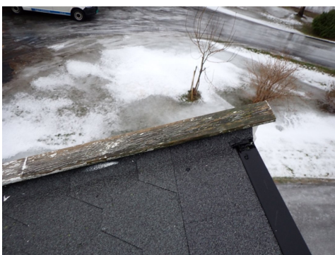
Slitasje i "vindskibeslag"
