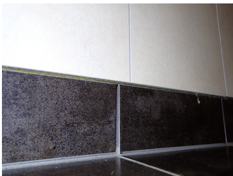
Bunnlist og fugging mangler
