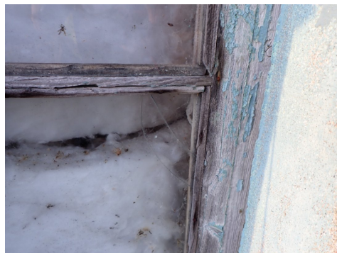
Eksempel på sprekker/utvendig slitasje
