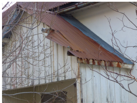
Skader på tak/vindskibord over inngangsparti
