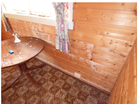
Fuktskjolder på panel i stua, lekkasje fra vindu
