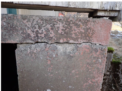
Sprekker mellom dekke og bærende element
