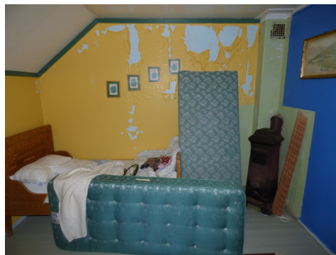
Soverom mot sørøst, maling flasser/faller av
