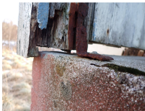
Råteskader, sidevegg mot øst
