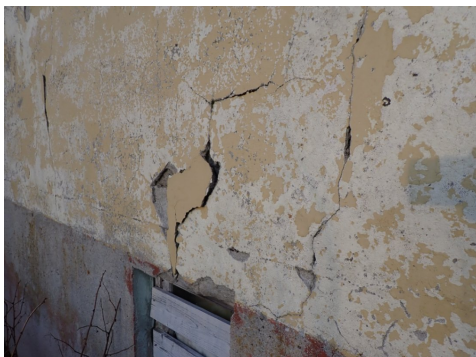
Eksempel på oppsprekking (sør)
