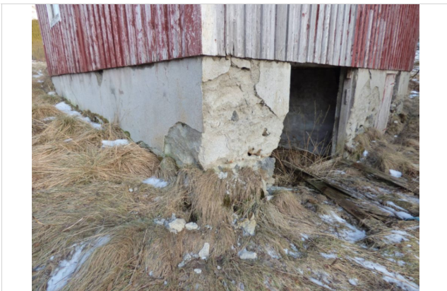
Skader i mur, hjørne mot sørvest
