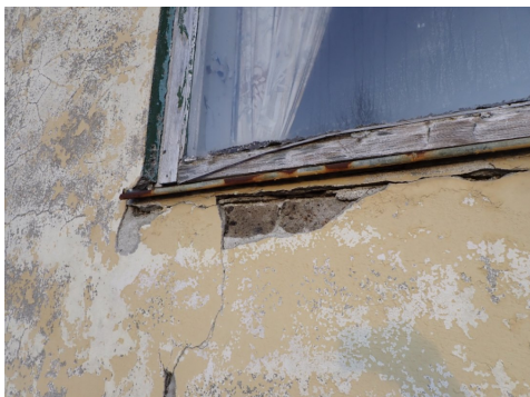
Eksempel på utvendig slitasje
