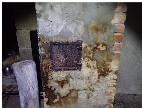
Rust på sotluka
