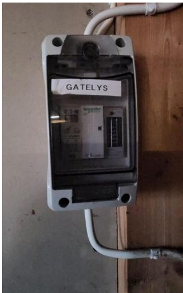
Elektrisk anlegg - [Målertil gatelys i garasje. ]
