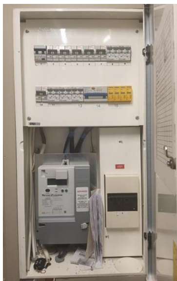
Elektrisk anlegg - [Sikringsskap]
