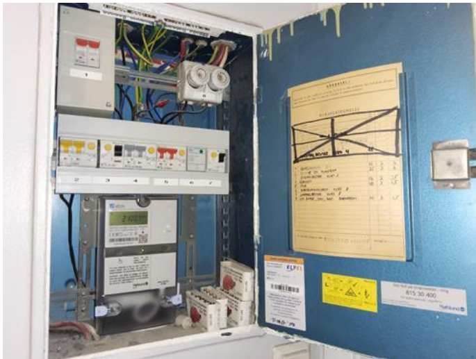
Beskrivelse - [Sikringsskap med kursfortegnelse. ]
