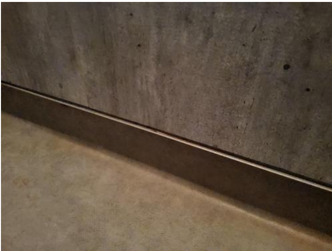
Overflater vegger - [Eksempel på manglende silikonerings mellom veggplater og bunlist på bad.]
