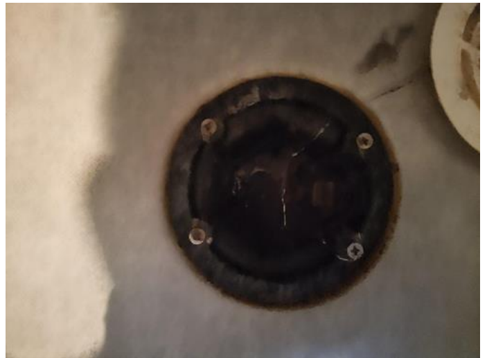
Avløpsrør (ink. sluk) - [Sluk på bad. ]
