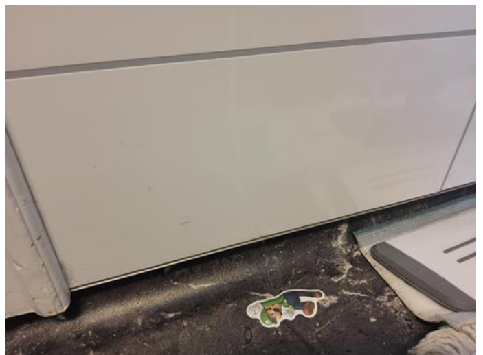
Overflater vegger - [Manglende silikonering underkant veggplater på vaskerom.]
