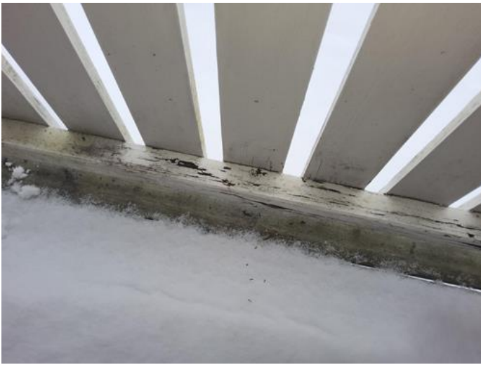
Balkonger, terrasser, veranda etc - [Eksempel på råteskader i rekkverk på balkong ved stort soverom. ]
