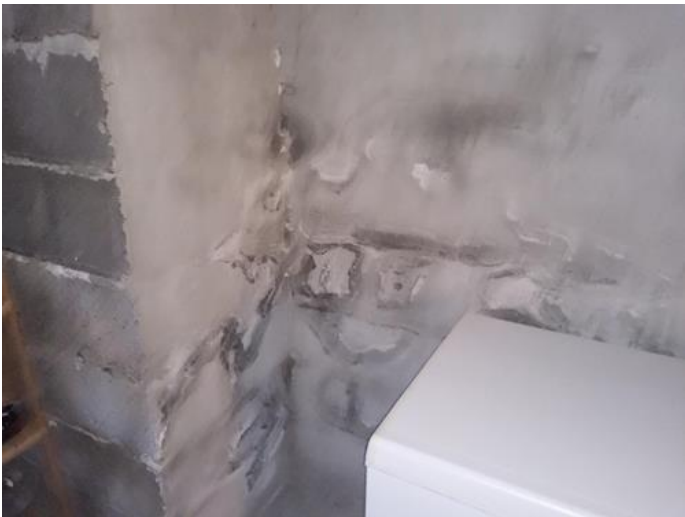
Overflater vegger - [Eksempel på fuktmerker på vegger i kjeller.]
