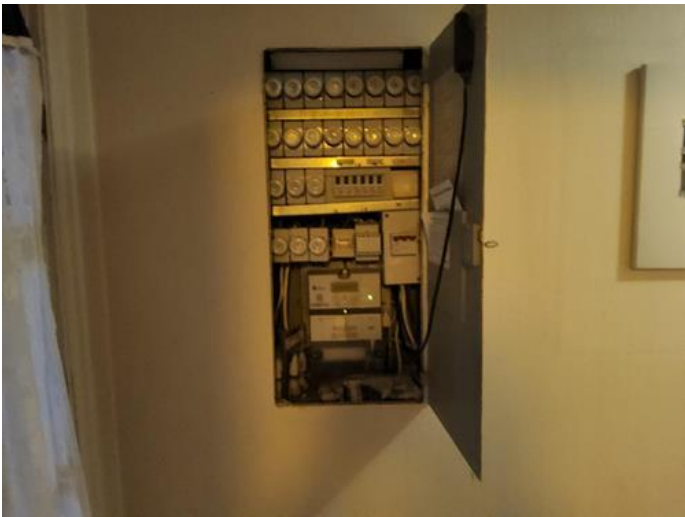
Elektrisk anlegg - [Sikringskap ]
