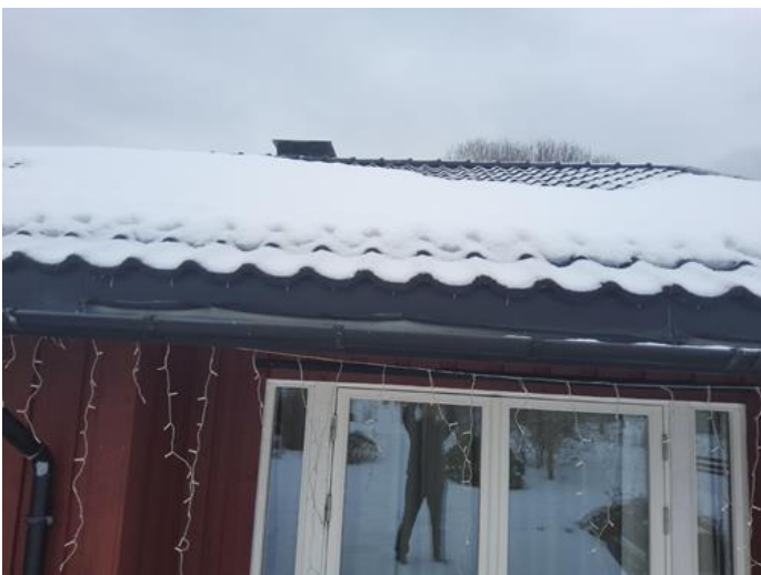
Beslag, renner, nedløp og snøfangere - [Eksempel på slitasje på takforbeslag. ]
