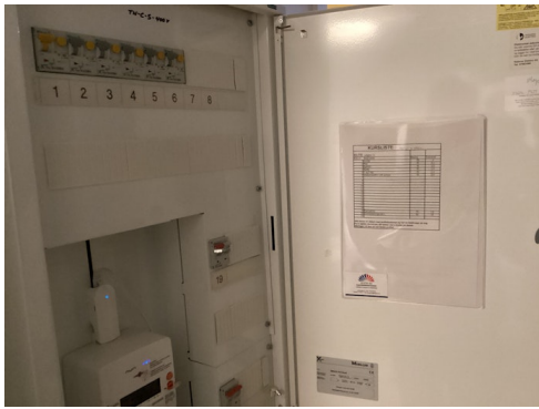
Bilde av sikringskap
