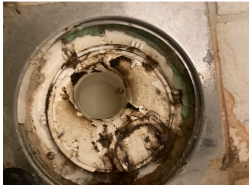
Bilde av sluk.
