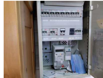
Elektrisk anlegg - [Sikringskap]
