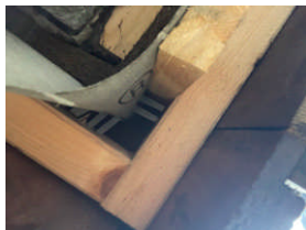
Manglende museband i hjørner bak bordkledning.
