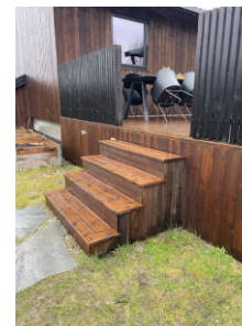
Trapp uten rekkverk.
