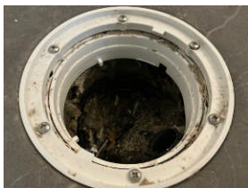
Gulvbelegg er lagt under klemring i sluk.
