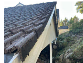
Taket har en del mose og fremstår slitt. Det er anbefalt å fjerne mose fra tak, da dette foringer levetiden på taket.
