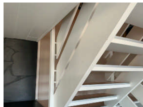
Åpninger mellom trinn på over 10cm.
