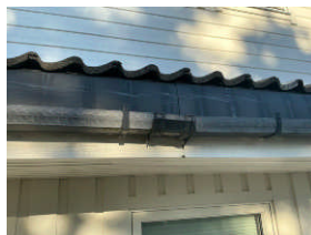
Takrenner av plast. Det er skjevheter i takrenner.
