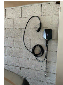
Det er montert elbil lader i garasje.
