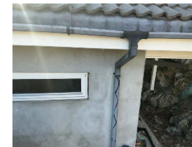
Takrenner av plast. Det anbefales utskifting av takrenner på garasje.
