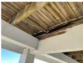
Bærende drager med råteskade.
