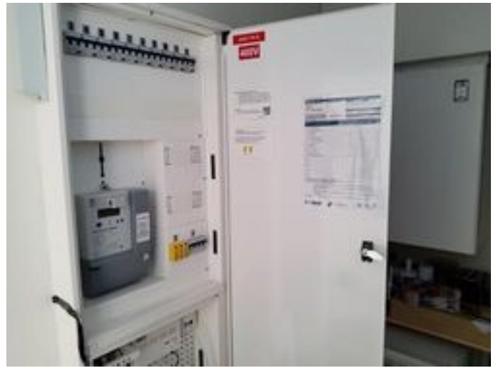
Elektrisk anlegg - [Sikringskap ]
