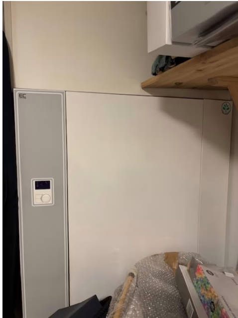
Ventilasjonsaggregat plassert veggghengt på teknisk rom.
