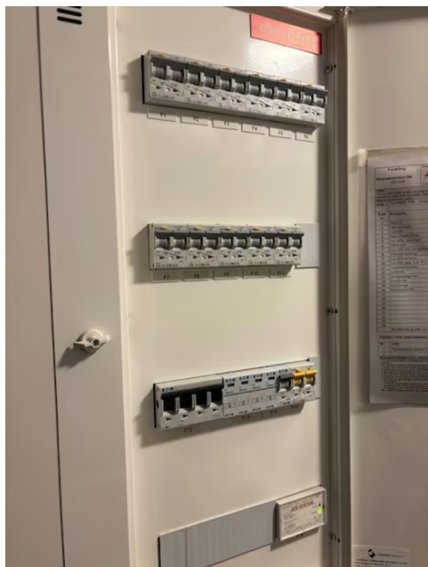
Sikringsskap med automatsikringer plassert i teknisk rom.
