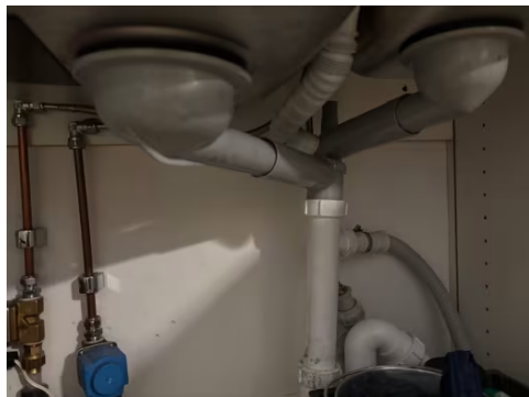
Avløpsrør i underskap vask på kjøkkenet.
