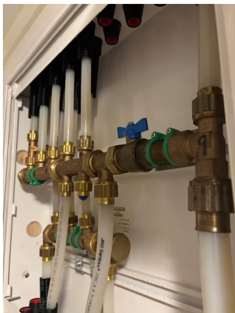
Rørfordelerskap med stoppekran plassert i vegg på teknisk rom.
