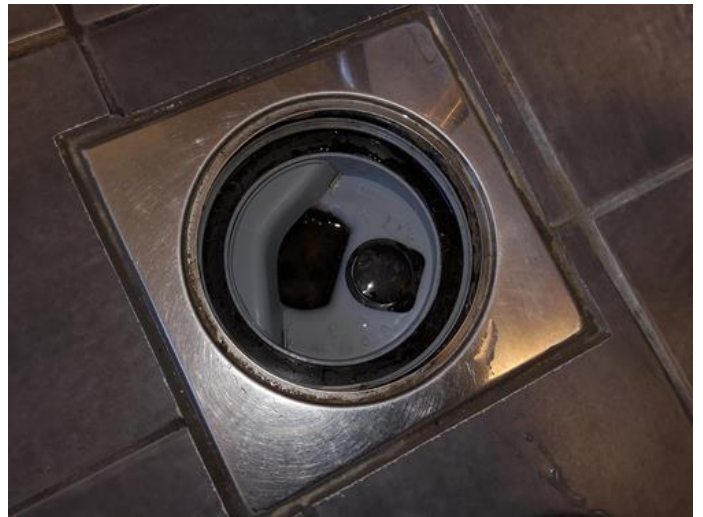
Kommentar - [Sluk vaskerom]
