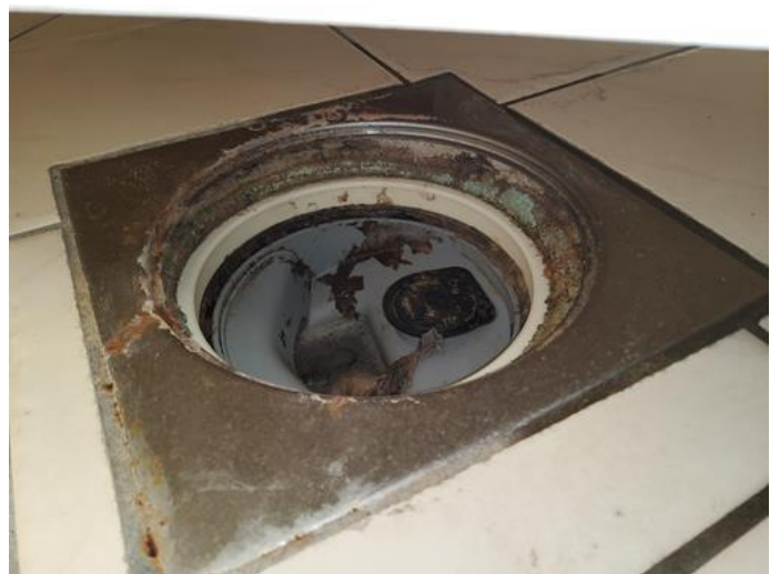
Kommentar - [Sluk under dusjkabinett bad 1.etasje]
