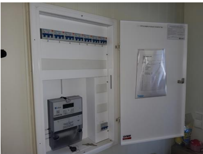
Beskrivelse - [Sikringskap underetasje]
