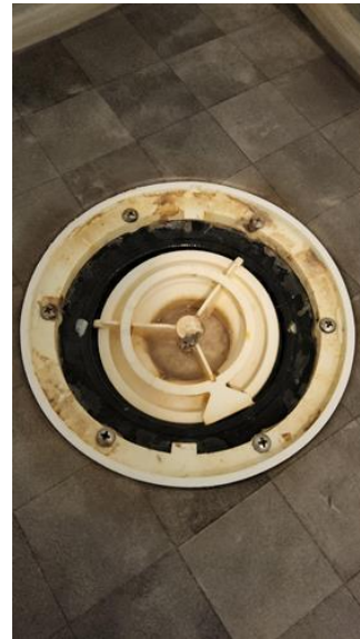
Avløpsrør (ink. sluk) - [Sluk bad]
