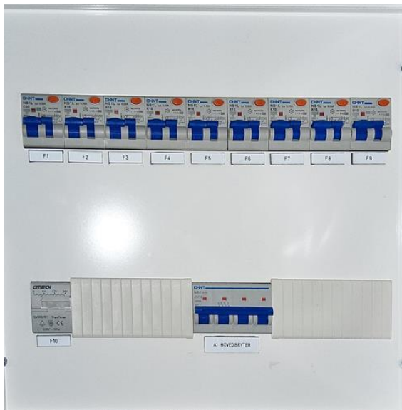
Forenklet vurdering av det elektriske anlegget - [Sikringsskap]
