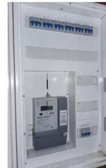
Elektrisk anlegg - [Sikringskap. ]
