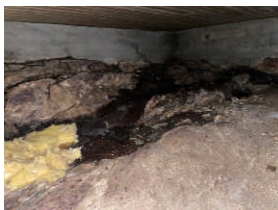
Fjell/berg i kryprom. Det renner vann inn langs berget.
