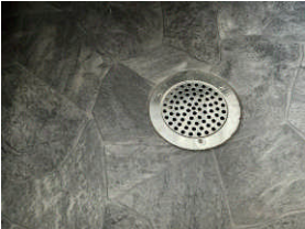
Sluk i gulv midt på gulvet.
