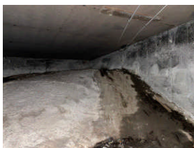
Fjell/berg i kryprom. Det renner vann inn langs berget.
