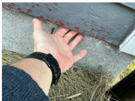
Manglende/lite lufting bak kledning.
