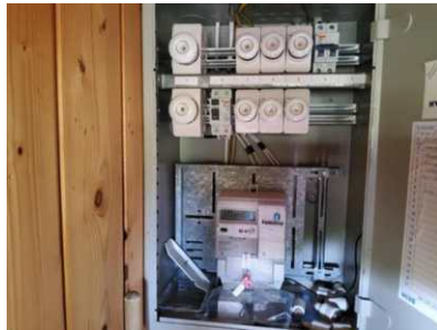
Elektrisk anlegg - [Sikringskap]
