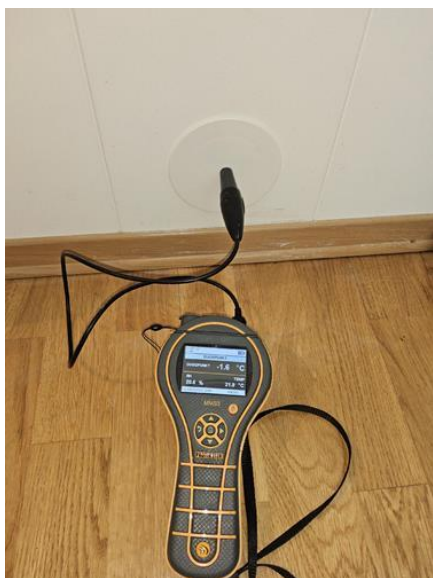
Våtrom - [Fuktmåling bad uten forhøyede fuktverdier ]
