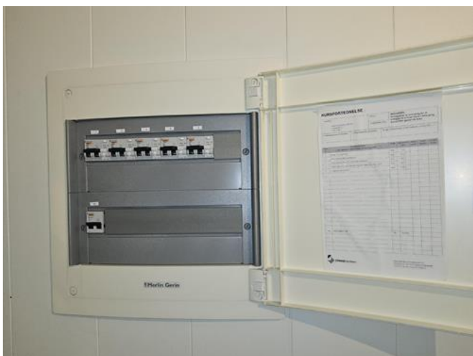
Elektrisk anlegg - [Sikringskap ]
