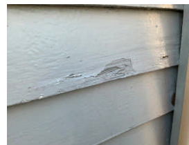
Det er gamle skader i kledning som er overmalt.
