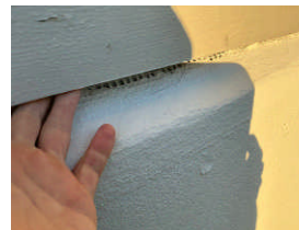
Manglende lufting bak kledning grunnet utforing/etterisolering av grunnmur. Lufting bør etableres.
