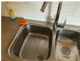
Drypplekkasje fra blandebeholder.
