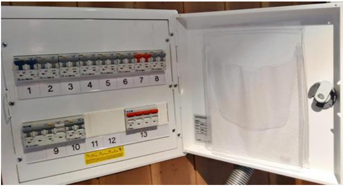
Elektrisk anlegg - [Sikringskap]
