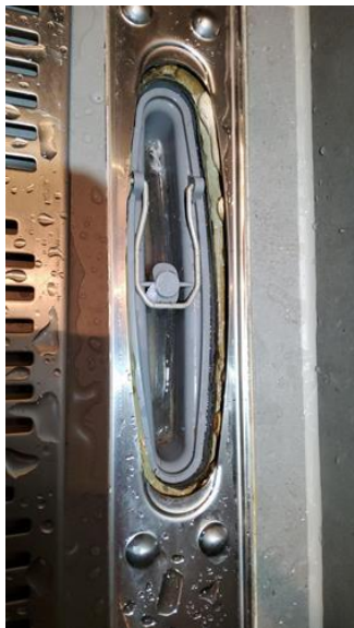
Våtrom - [Sluk bad loft 2]
