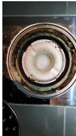
Våtrom - [Sluk bad loft]
