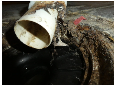
Avløpsrør fra dusjkabinett til sluket
