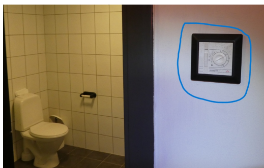
Varmekabel bad - kurs ikke merket i sikringskapp
