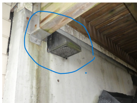
Igjen trodd åpninger i ventilasjons beslag
