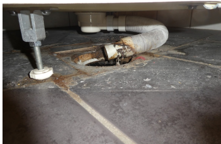
Sluk under dusjkabinett
