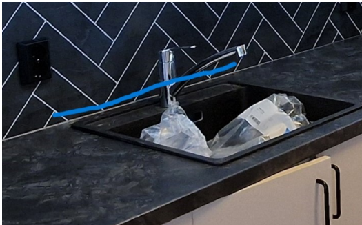
Skade i benkeplate
