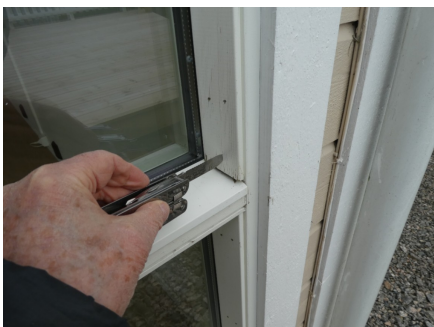
Sprekker i list og noe i underarmen
