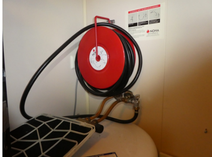
Brannslange montert i teknisk rom
