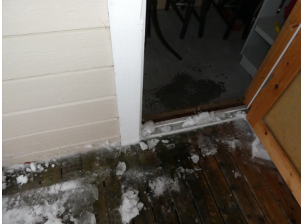
Lite gunstig tilslutning av terrasse mot kledning
