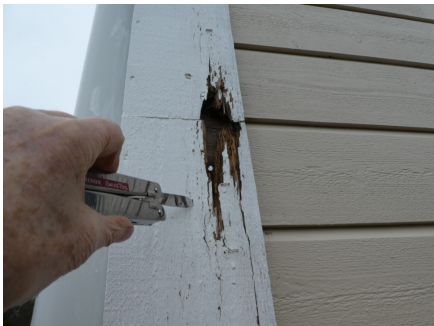
Stedvis fukt skadet kledning
