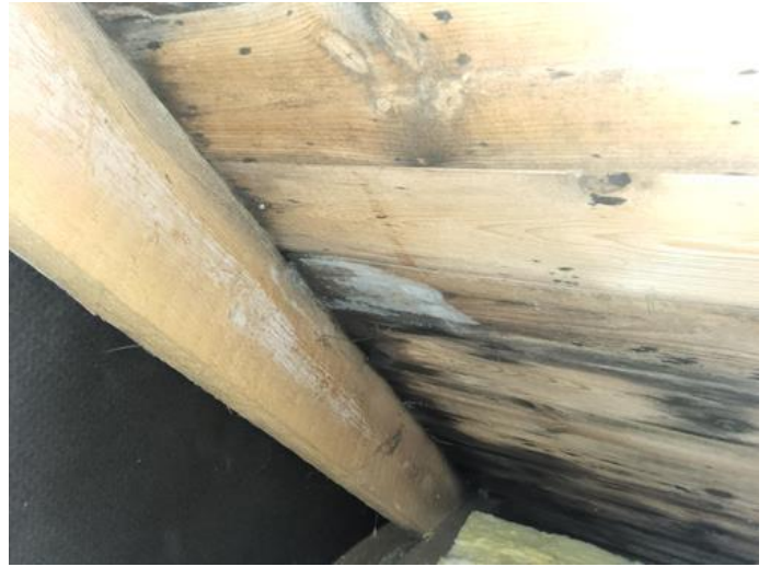
Kommentar - [Fuktskader undertak råloft ]
