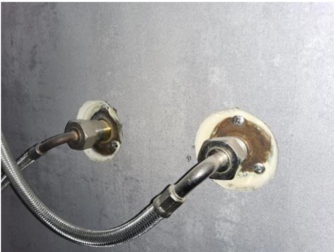
Kommentar - [Utførelse tettedetaljer ved vannrør til dusjkabinett ]
