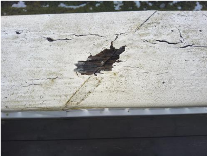
Kommentar - [Råteskade toppbord på rekkverk terrasse ]
