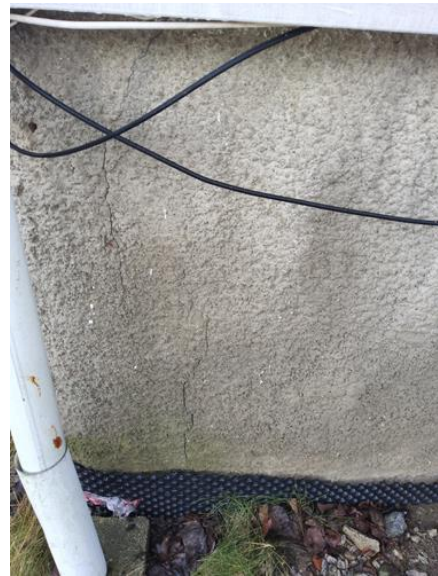
Kommentar - [Riss/sprekk grunnmur ]
