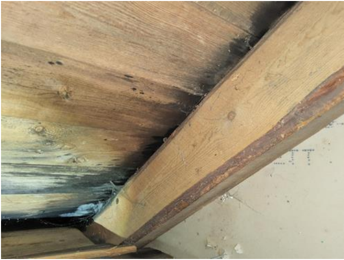
Kommentar - [Fuktskader undertak råloft ]
