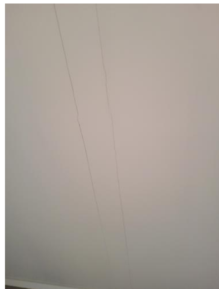
Kommentar - [Sprekker plateskjøter himling stue ]
