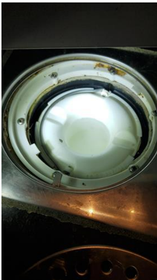
Våtrom - [sluk bad 2 etg]
