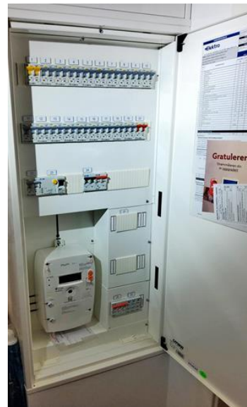
Elektrisk anlegg - [Sikringskap]
