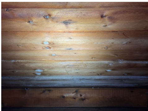
Misfarging i sutak på loft.
