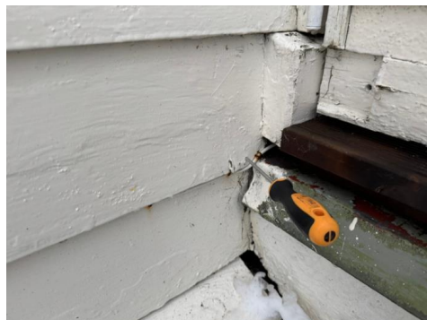
Råteskader i kledningsbord.
