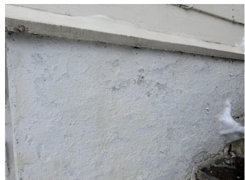
Slitasje/malingsflass på grunnmur.
