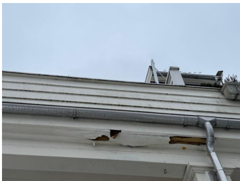
Utettheter i ytre del av altan. Må utbedres snarlig slik at ikke følgeskader på naboens altan blir større.
