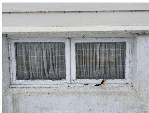
Råteskader i vindu i u-etg.
