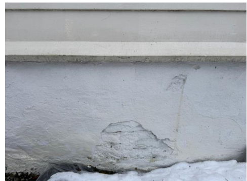
Løs puss på grunnmur.
