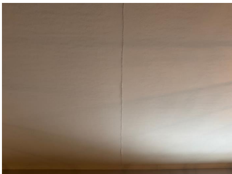
Riss/sprekke i himling i stue i 2-etg.
