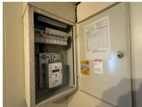
Sikringsskap i trapperom.
