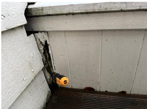
Råteskader i trevirke.
