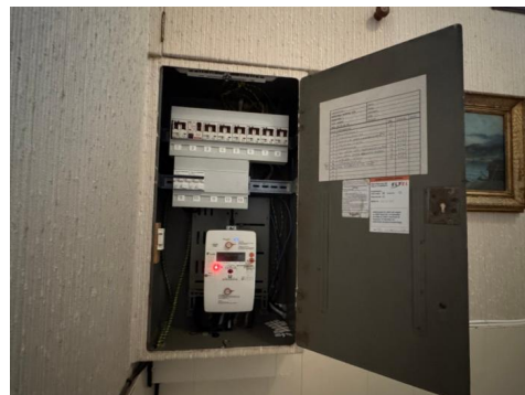
Sikringsskap i trapperom.
