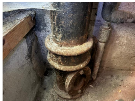
Stakeluke i u-etg. Rust ble observert på avløpsrør.
