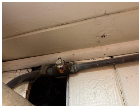
Det drypper fra vannrør v/ himling i vaskekjeller.
