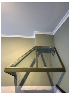
Hette over kokesone. Ventilator bør monteres.
