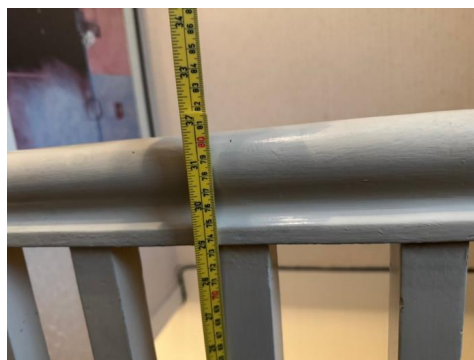
Lavt rekkverk i 2-etg.
