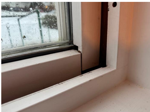
Karm på soveromsvindu i 1-etg er delvis ute av posisjon.
