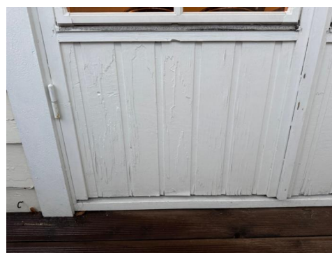
Slitasje/begynnende råte i utvendig panel på altandør i 1-etg.
