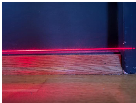
Bilder viser skjevheter i gulv i stue i 2-etg.
