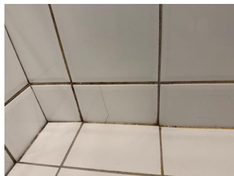
Sprekk i veggflis i dusjsone.
