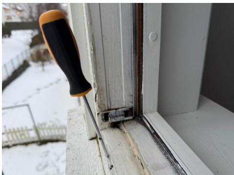
Råteskade i vindu i 2-etg.
