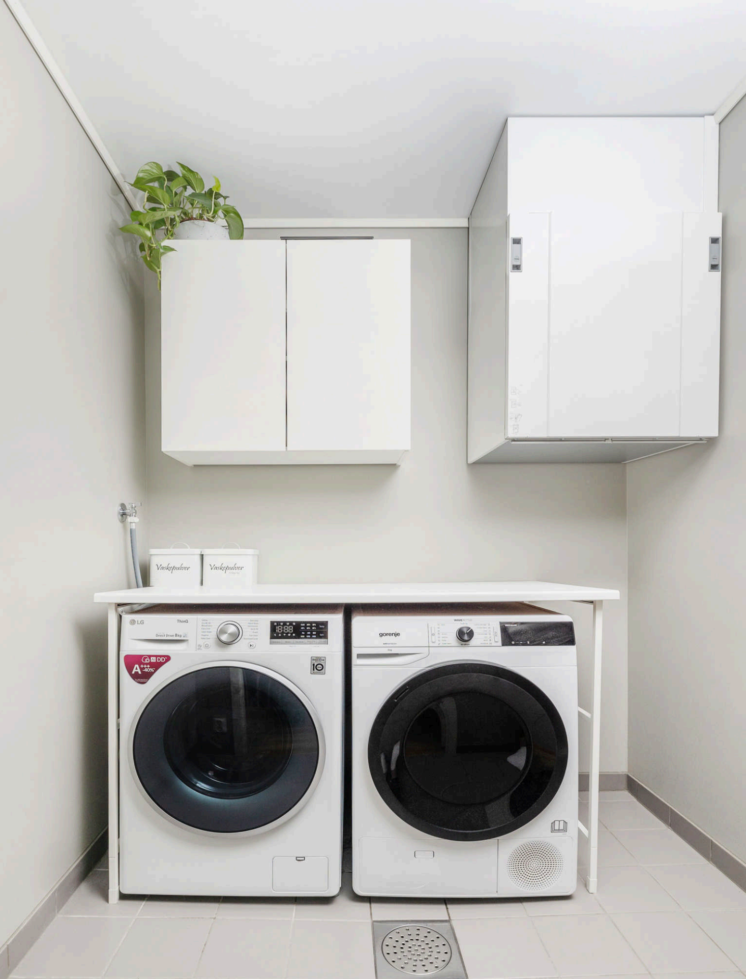
Praktisk med eget vaskerom. Til høyre ser du ventilasjonsanlegget.
