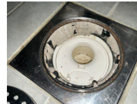
Sluk på vaskerom.
