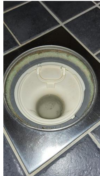
Avløpsrør (ink. sluk) - [Sluk bad]
