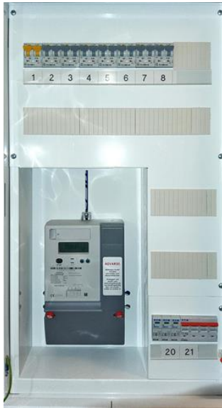
Forenklet vurdering av det elektriske anlegget - [Sikringskap]
