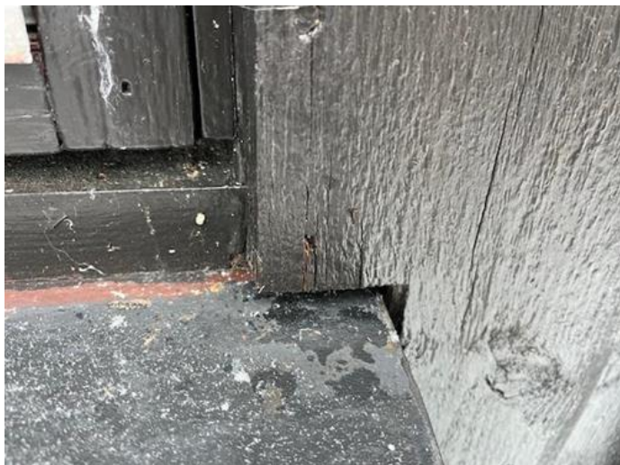
Kommentar - [Eksempel på råteskader]
