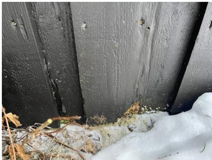
Kommentar - [Eksempel på råteskader]
