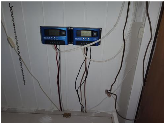
Elektrisk anlegg - [Elektrisk anlegg]
