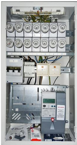
Forenklet vurdering av det elektriske anlegget - [Sikringsskap]
