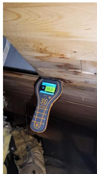
Overflater vegger/undertak - [Fuktmerker i taktro]
