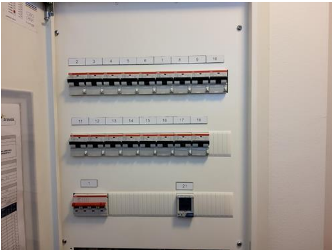
Elektrisk anlegg - [Sikringskap. ]
