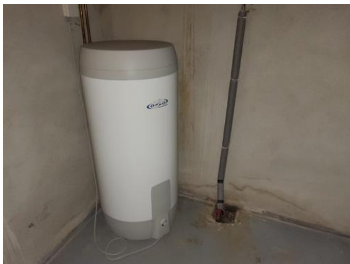
Hovedstoppekran - [Hovedstoppekran og varmtvannsbereder]
