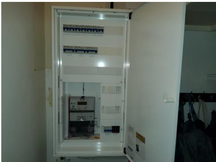
Elektrisk anlegg - [Sikringsskap]
