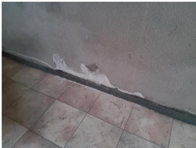
Overflater vegger - [Eksempel på salt/kalkutslag]
