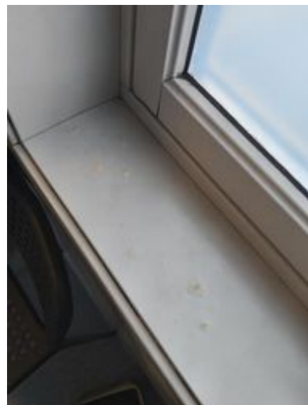
Vinduer - [Vindu på bad ]
