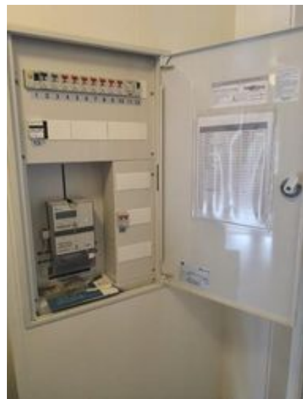
Elektrisk anlegg - [Sikringskap ]
