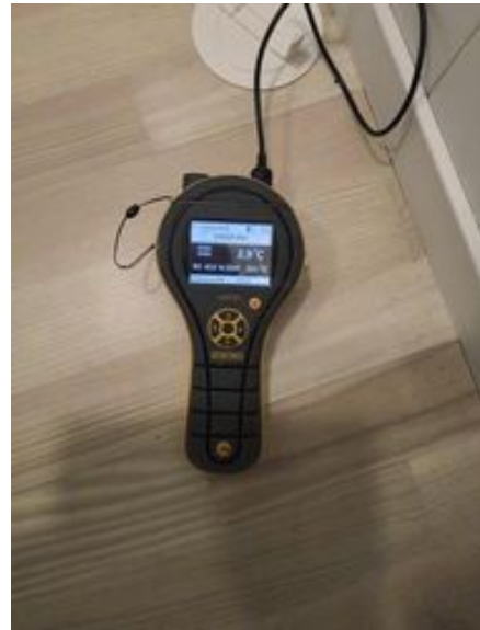
Fukt i tilliggende konstruksjoner - [Fuktmåling vaskerom ]
