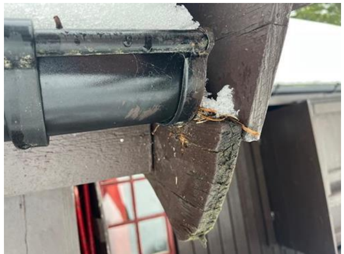
Konstruksjon - [Råteskader på vindski]
