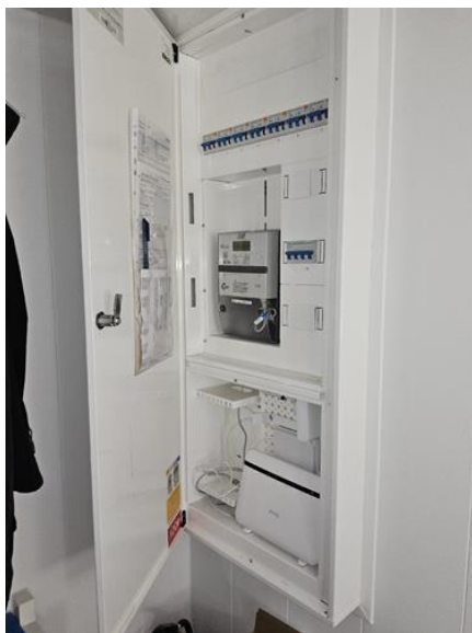
Elektrisk anlegg - [Sikringskap ]
