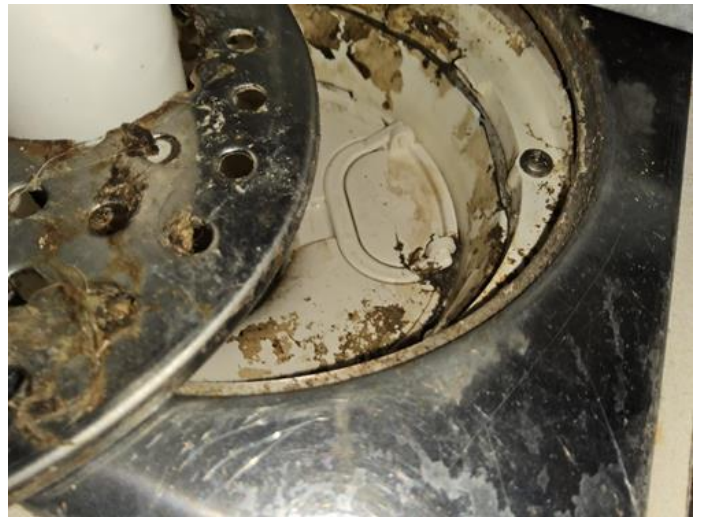
Våtrom - [Sluk bad.]
