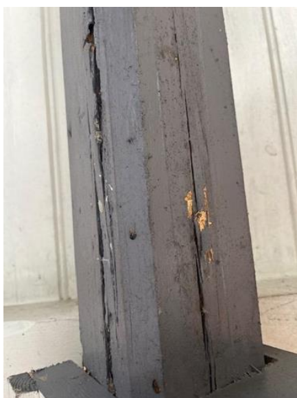
Helhetsvurdering - [Skader i konstruksjon ved balkong]
