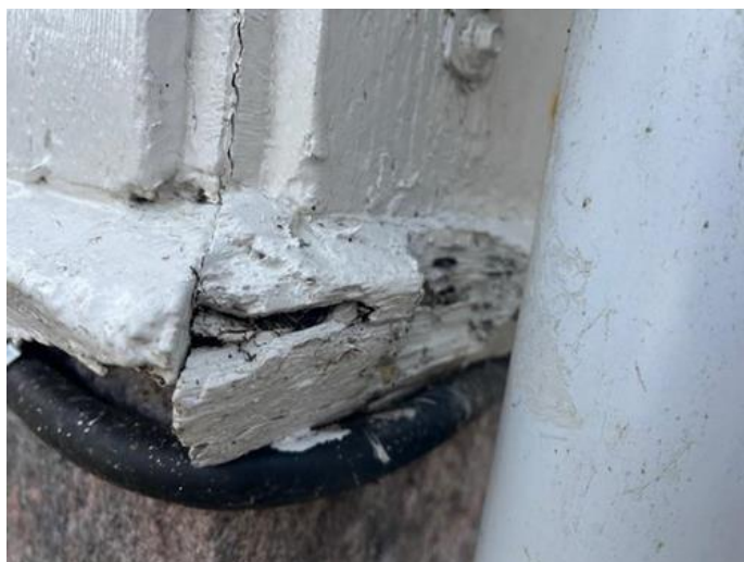
Helhetsvurdering - [Råteskader i hjørne ]
