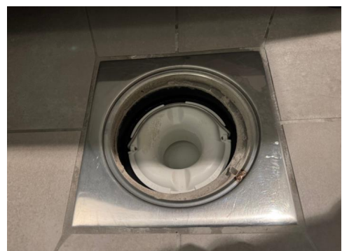
Plastsluk i gulv.
