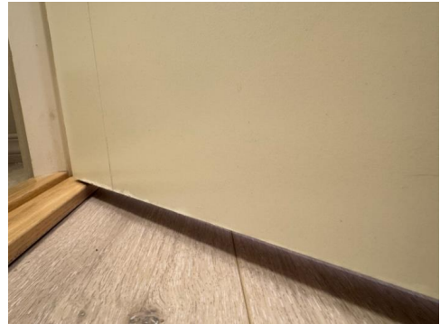
Fuktutsvelling/slitasje i nedre del av toalettromdør.
