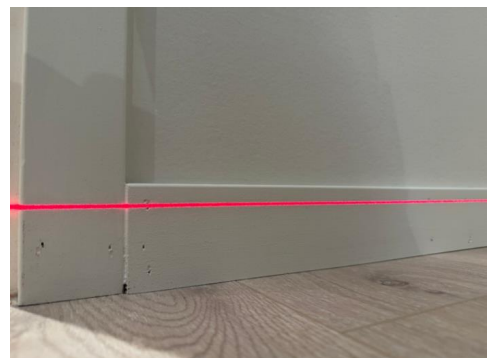
Bilder viser skjevheter i gulv i entre/gang.
