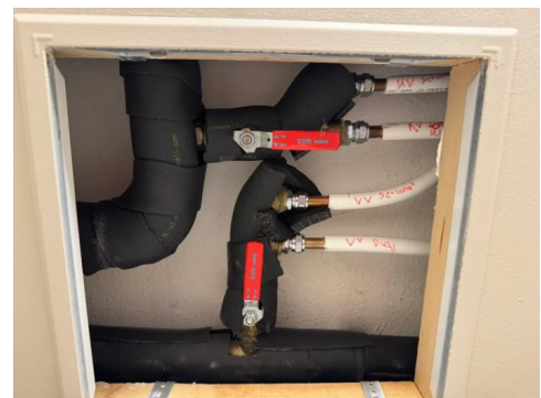
Stoppekraner i himling på toalettrom.
