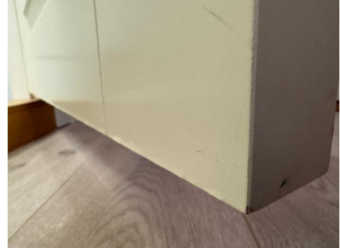
Fuktutsvelling/slitasje i nedre del av badedør.
