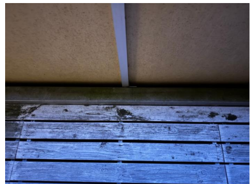
Slitasje i tretrekker/terrassebord.
