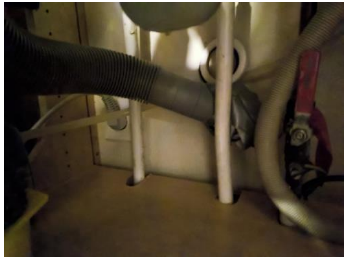
Avløpsrør - [Avløpsrør under vasken på kjøkken ]
