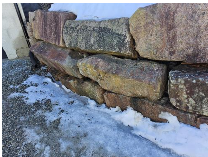
Utvendig - [Skjevheter påvist forstøtningsmur ]
