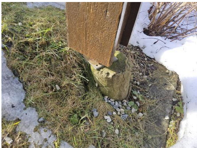
Utvendig - [Løst og skjevt fundament til terrasse ]
