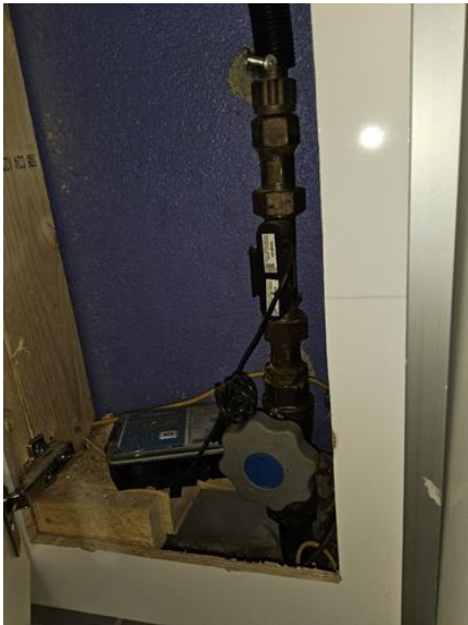
Tekniske anlegg, VVS anlegg (Sjekkpunkter utover det som er inkludert i andre rom) - [Vanninntaksrør med hovedstoppekran ]
