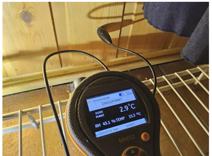
Konstruksjoner (tilfarergulv, himling og vegger). - [Fuktmåling i utleket kjellervegg ]
