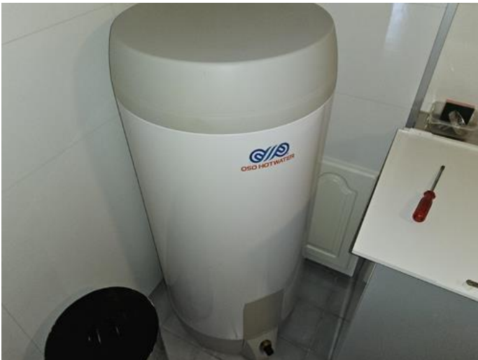
Tekniske anlegg, VVS anlegg (Sjekkpunkter utover det som er inkludert i andre rom) - [Varmtvannsbereder ]
