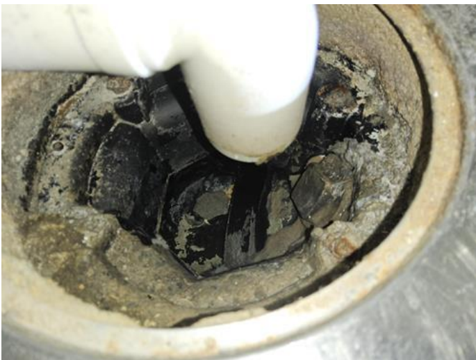
Avløpsrør (ink. sluk) - [Sluk vaskerom ]
