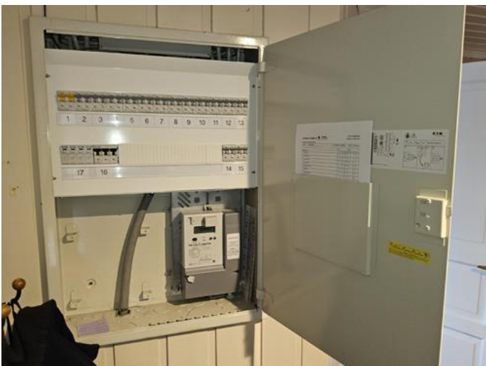
Elektrisk anlegg - [Sikringskap ]
