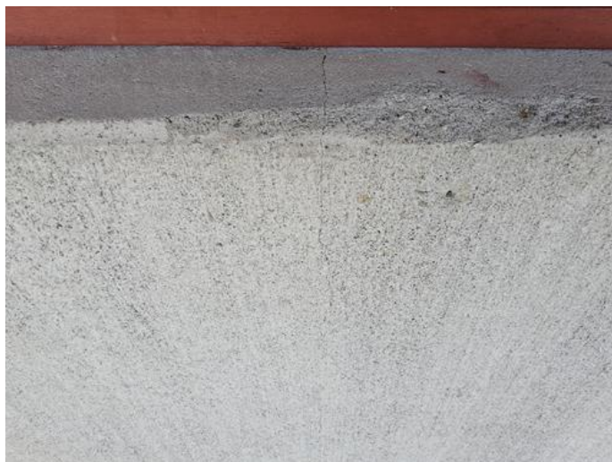
Utvendig - [Eksempel på riss/sprekk i grunnmur ]
