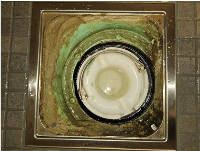
Avløpsrør (ink. sluk) - [Sluk bad underetasje ]
