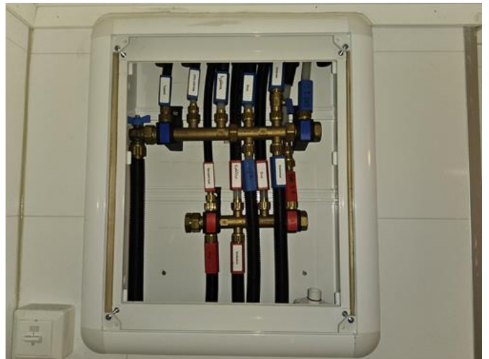
Tekniske anlegg, VVS anlegg (Sjekkpunkter utover det som er inkludert i andre rom) - [Fordelerskap for rør-i-rør-systemet ]
