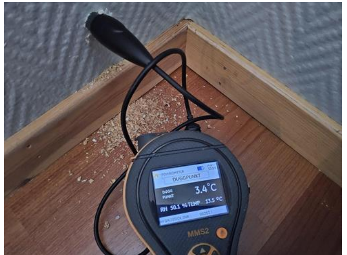
Våtrom - [Fuktmåling bad underetasje ]
