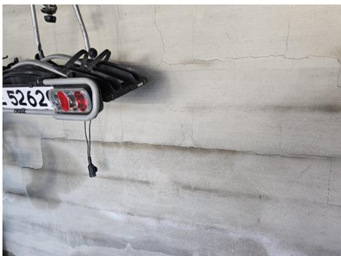
Utvendig - [Sprekker i grunnmur garasje ]
