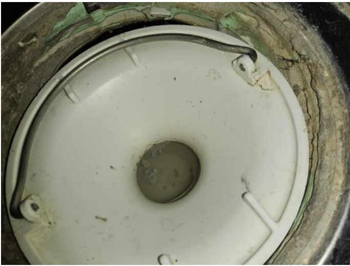
Avløpsrør (ink. sluk) - [Sluk bad 1.etasje ]
