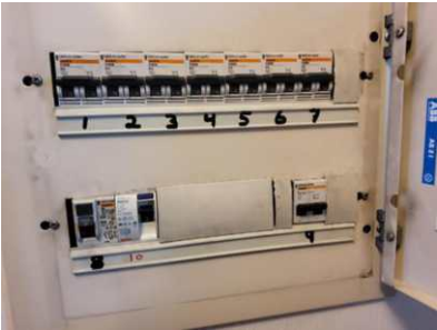
Elektrisk anlegg - [Sikringskap. ]
