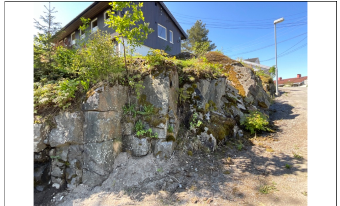
Det bør sikres på topp fjell.
