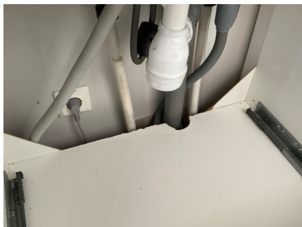
Svellinger i kjøkkenskrog ved rør.
