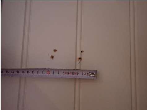
"Ansamling" av merker i vegg (stue)
