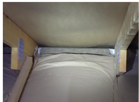
Nedbøyning av undertaksplater
