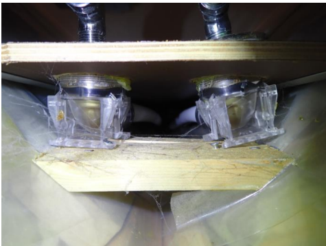
Innfestinger løsner/er løse
