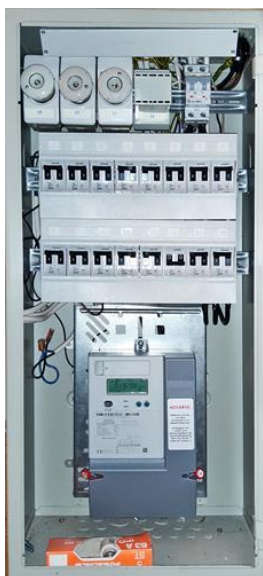
Forenklet vurdering av det elektriske anlegget - [Sikringsskap]
