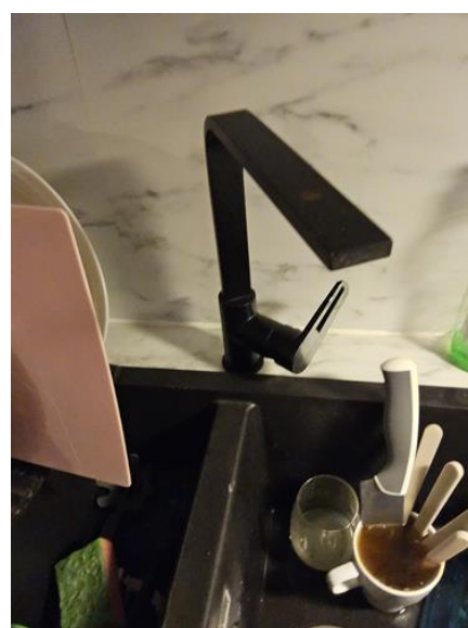
Kjøkken - [Løs armatur på kjøkken i leiligheten. ]
