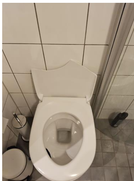
Våtrom - [Knekt lokk til toalettsete. ]
