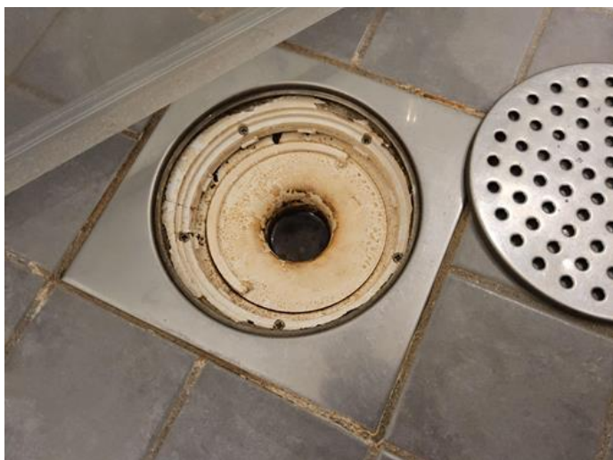
Våtrom - [Sluk på bad i hybel.]
