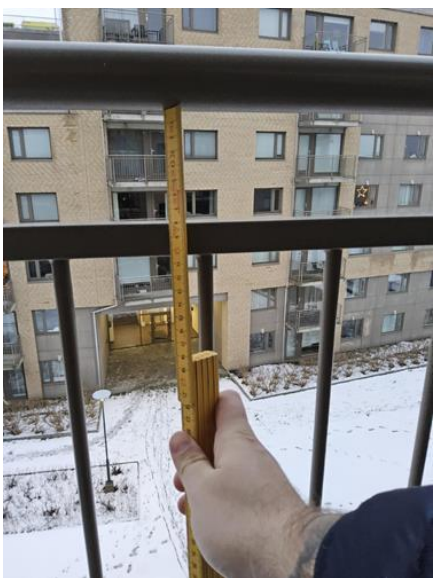
Balkonger, terrasser, veranda etc - [Horisontal åpning i rekkverk på mer enn 5cm.]
