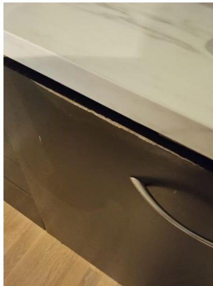
Kjøkken - [Skade på innredning (dekkfront til oppvaskmaskin).]
