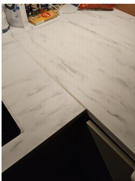
Kjøkken - [Høydeforskjell i skjøt mellom benkeplatene (kjøkken i hybel).]
