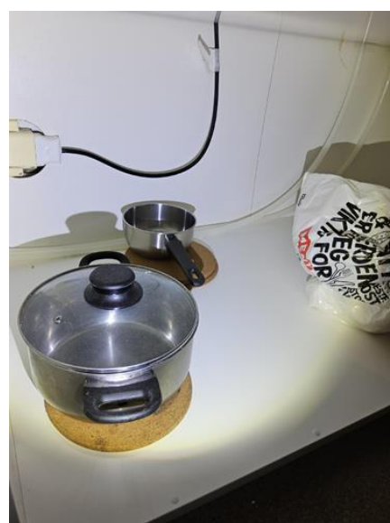
Kjøkken - [Vannrør ikke montert med varerør. ]
