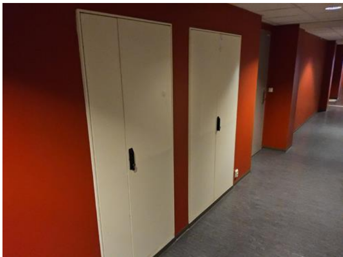
Elektrisk anlegg - [Sikringsskap.]
