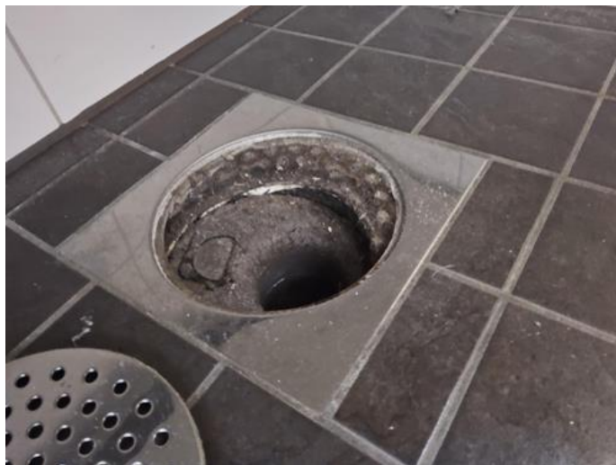
Våtrom - [Sluk på bad (hjelpesluk under servantinnredning)]
