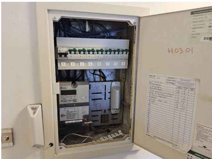
Elektrisk anlegg - [Sikringsskap]
