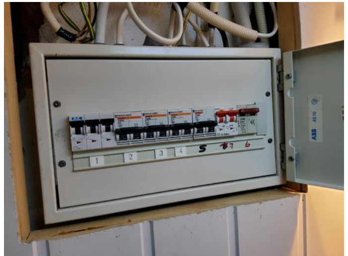
Elektrisk anlegg - [Sikringsskap kjeller]
