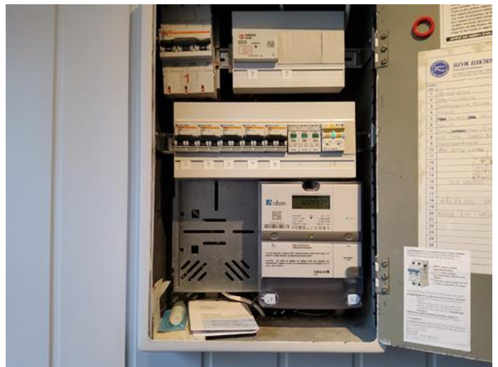
Elektrisk anlegg - [Sikringsskap 2. etg.]
