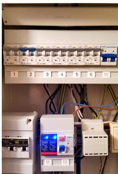
Forenklet vurdering av det elektriske anlegget - [Sikringskap nr 2]
