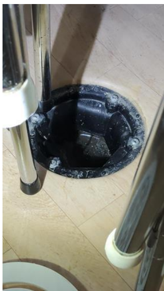
Avløpsrør. (Sjekkpunkter utover det som er inkludert i andre rom) - [Sluk i bod nr 2 i underetasje]
