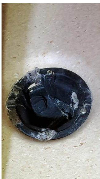
Helhetsvurdering - [Sluk på bad i 1. etasje]
