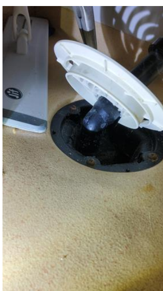
Helhetsvurdering - [Sluk i vaskerom]
