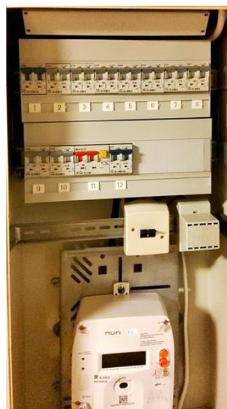
Forenklet vurdering av det elektriske anlegget - [Sikringskap]
