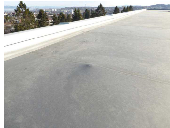
Innfesting til isolasjon har løsnet/er på vei opp.
