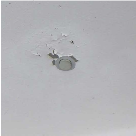
Malingsavflassing rundt propp, som presses ut av vann.
