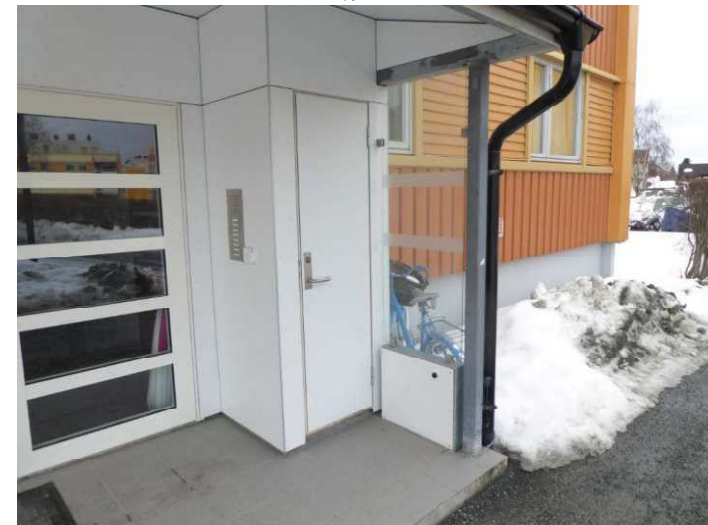
Døren stopper i muren, når den åpnes mer enn 90 grader.
