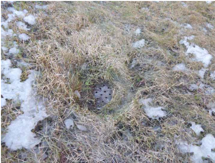
Sluk for drenering av vann mellom blokkene.
