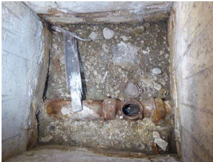
Avløpsrør i stakelum. Manglende lokk. Ingen rotter observert på befarig.
