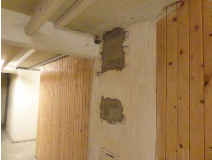
Tidligere gjennomføringer tettet.
