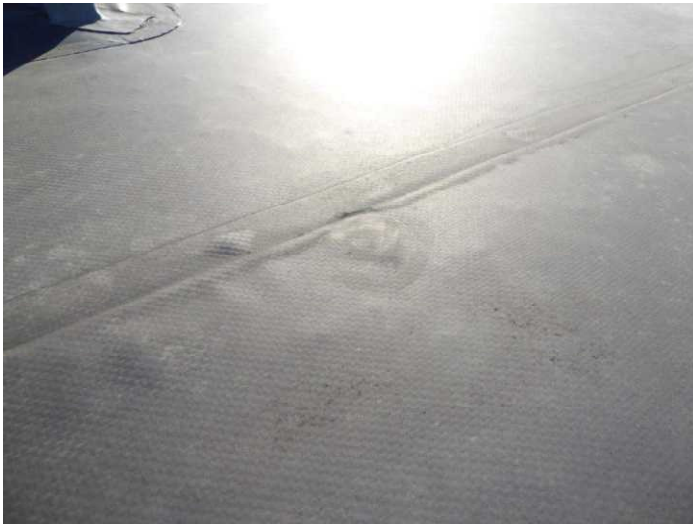
Bobler i skjøt.
