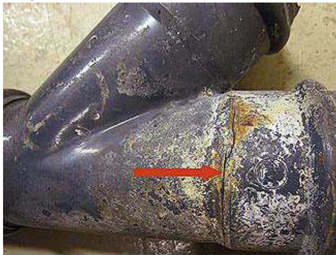
Illustrasjonsbilde brudd på avløpsrør.
