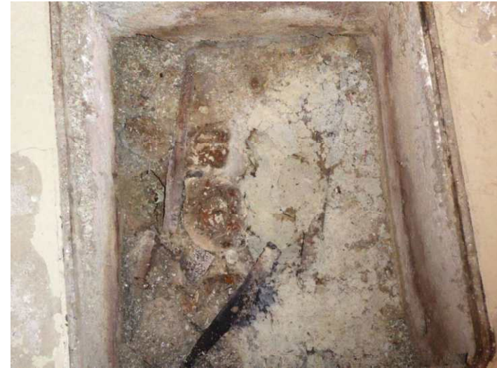
Rustet avløpsrør. Stakekum tidligere fylt med vann.
