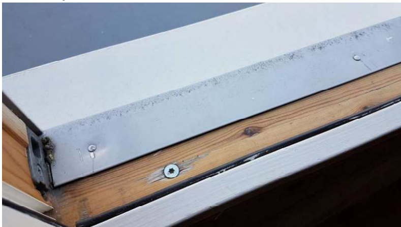
Sprukket glass i vindu (bilde fra 2015). Dette er skiftet.
