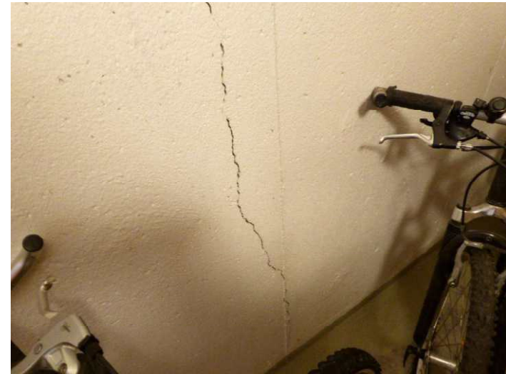
Riss i grunnmur.
