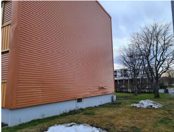
Fasadeplater inngangsside. Mindre bulker som kun er av estetisk betydning.
