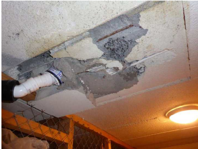
Synlig armering etter slukskifte.
